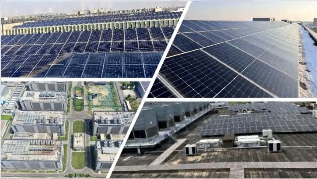
公司投建的光伏系统
